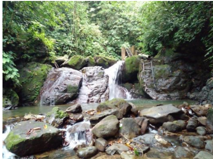
Gambar 5. Kerusakan Bendung Atas dan Pipa Pesat (Dok.Pribadi/Koaksi, 2023)
